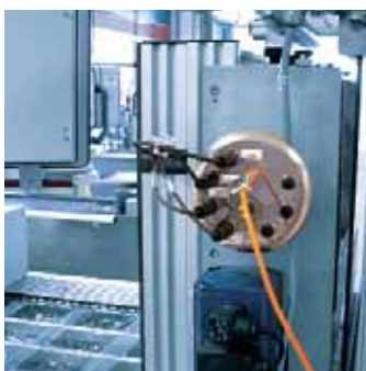
Le système RFID code et identifie les palettes d'une ligne de production.
